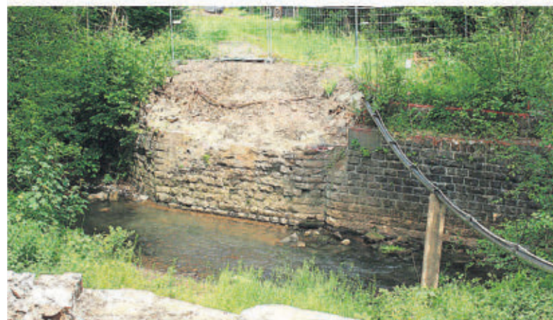
Die alte Brücke über die Nahe bei Türkismühle ist verschwunden und wird mit einer neuen Aluminium-Überführung ersetzt. FOTO: FRANK FABER
