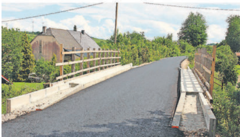
Auf der Strecke bei Wolfersweiler ist der Bahnradweg mit der Tragschicht bereits asphaltiert. FOTO: FRANK FABER
